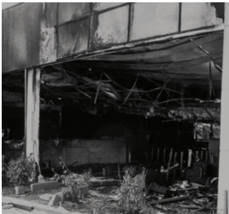
Cerro Navia, 17/11 resti di un'agenzia Banco Estado incendiata
